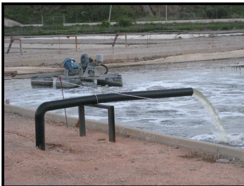
5. Detalle EDARI municipal del polígono industrial
